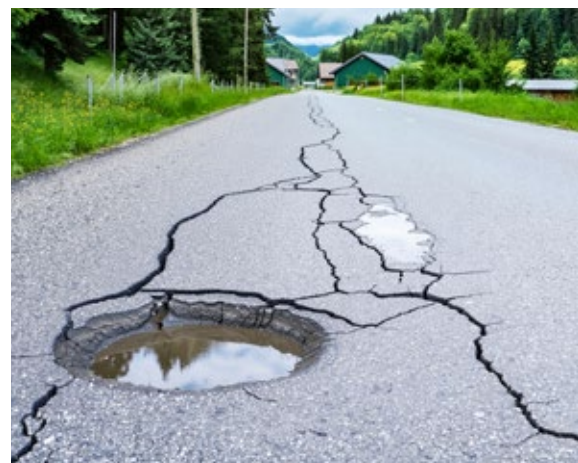
In mehreren Bereichen sind Sanierungen unserer Gemeindestraßen längst notwendig (Symbolfoto).
